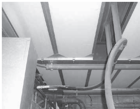
写真2 機械室内吸音
