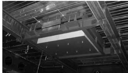
写真1 床下(天井裏)に取り付けるTMDの設置写真
